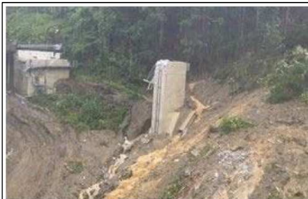
E32 高知道 新宮IC～大豊IC(土砂流出に伴う上部工流出) 西日本豪雨災害(NEXCO西日本HPより)
