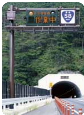
トンネル非常警報システム
