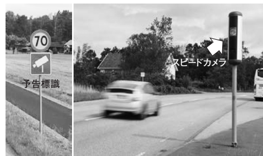
写真一10 スピードカメラ設置状況
