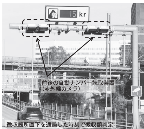
写真一12 徴収箇所の設備
