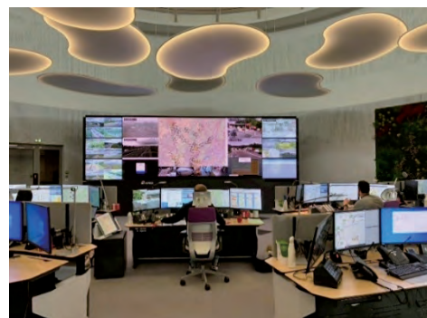
写真一4 管制センター状況
