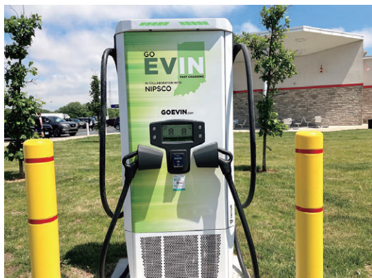
大型車給電施設
