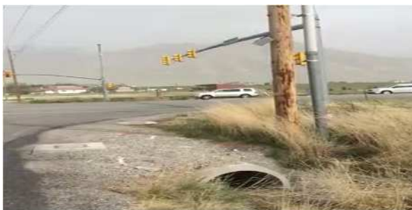
写真 2-3-15 信号機の振動状況
