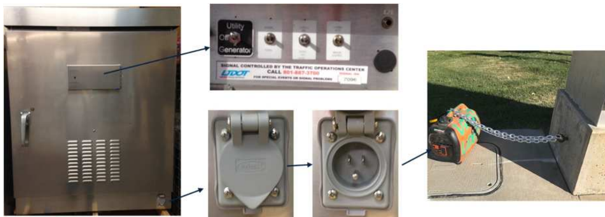
図 2-3-36 バックアップ電源用のプラグと発電機
