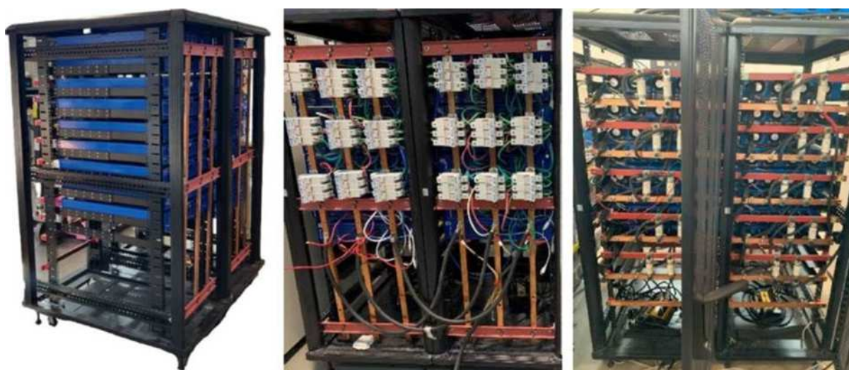
写真 2-5-2 AC 3相 480V 300kW モジュール型急速充電器
