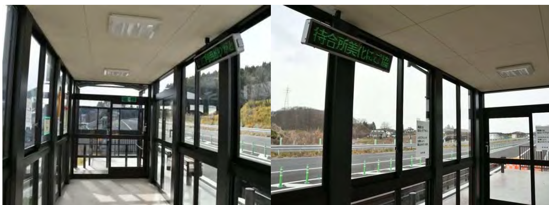
図3.1.11 （参考事例）BS 待合室内に設置した LED 情報板の例（R2.12EHRF 撮影）
