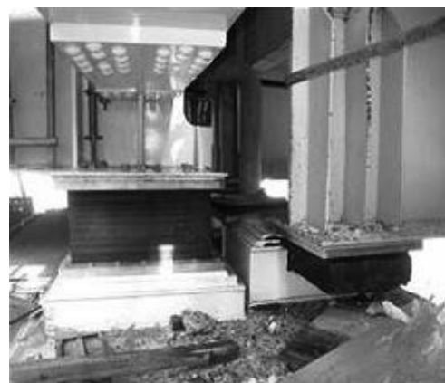
*3 【仙台東部高架橋のゴム支承の破断】
