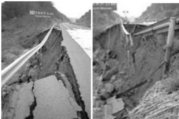
* 6 [東北道水沢—平泉前沢間盛土部の崩落]
