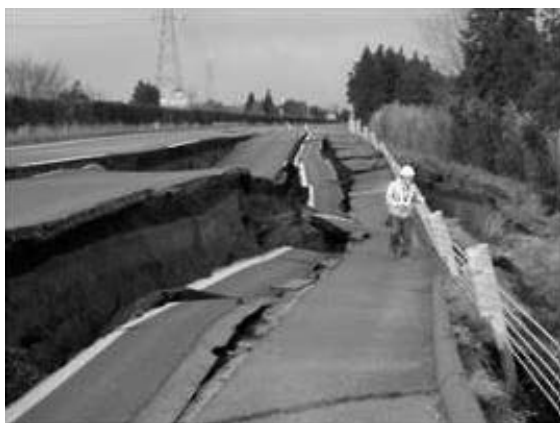
*2 【常磐道水戸—那珂間盛土部の崩壊状況】
