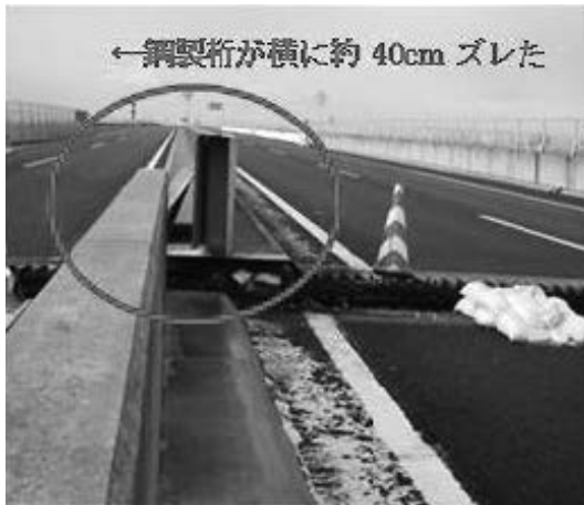
* 4 [仙台東部高架橋の鋼製桁損傷によるズレ]
