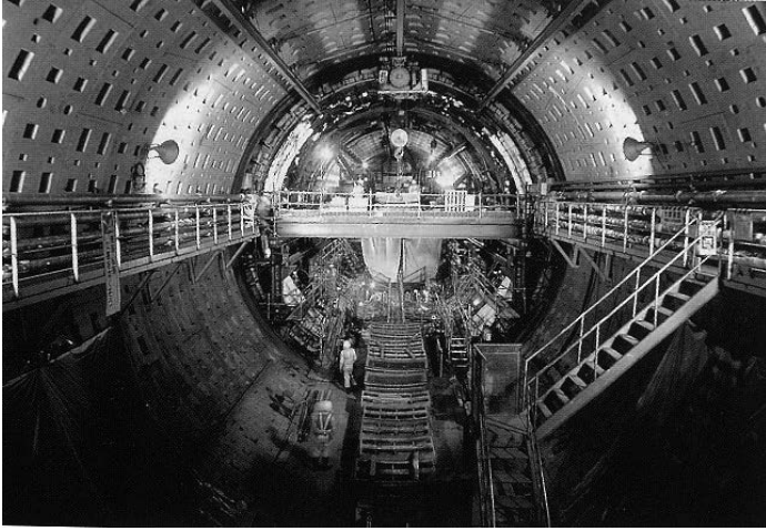
* 2 【東京湾アクアラインの地中でのシールドトンネルの閉合】 （「東京支社から東京建設局～50年の建設史」・日本道路公団東京建設局・平成17年6月）
