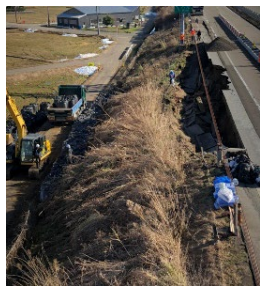
北陸道⑦202.6kp 盛土のり面崩落
