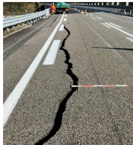
北陸道⑦193.1kp 走行路面クラック
