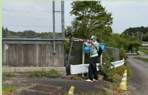
跨線橋(谷向西橋)と立入防止柵の隙間が空いているため小動物等の侵入が懸念
