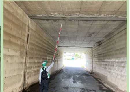
千代田石岡6C-Box樋部の継ぎ目からの漏水
